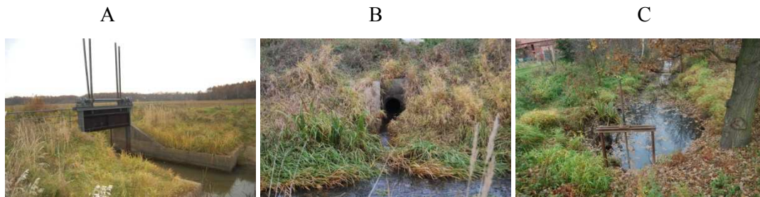
Rysunek 2. Urządzenia hydrotechniczne wspomagające retencjonowanie wody w zbiorniku Brodno (autor: Edyta Nowicka)
