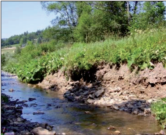
Fotografia 4.8. Erodowany prawy brzeg sekcji nr 3 potoku Kasinka (lipiec 2006) Photo 4.8. Eroded right bank of the section 3 of the Kasinka stream (July 2006)
