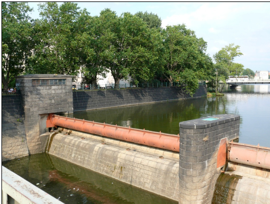
Fotografia 3. Nabrzeża towarzyszące budowlom piętrzącym przy elektrowni wodnej „Wrocław-północ” (zdjęcie autorów, czerwiec 2008 r.)
