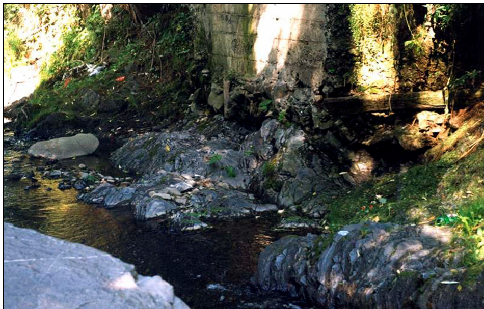
Fotografia 6. Uszkodzone filary mostu w korycie Mszanki – efekt erozji wgłębnej (fot. J. Korpak)
