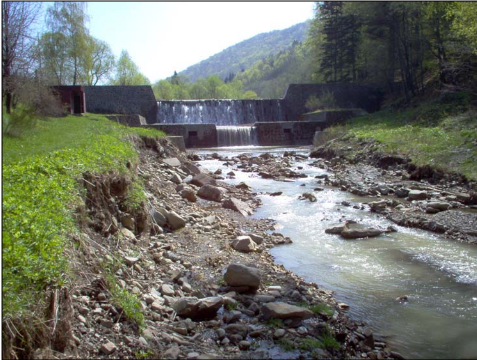
Rysunek 3. Zniszczenia koryta poniżej zapory
