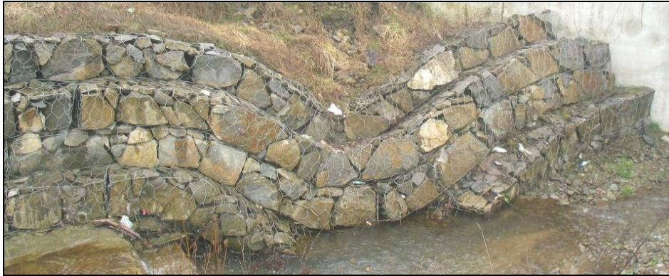
Fotografia 1. Uszkodzone umocnienie brzegu, potok Wyskitnianka, 2007 r. Picture 1. The bank protection failure, the Wyskitnianka stream, 2007
