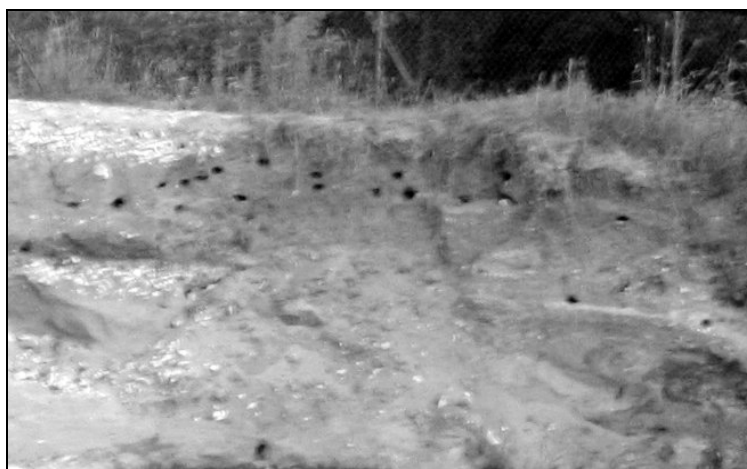
Rysunek 4. Wał przeciwpowodziowy uszkodzony przez zwierzęta nadwodne Figure 4. The embankment destroyed by the supraquatic animals
