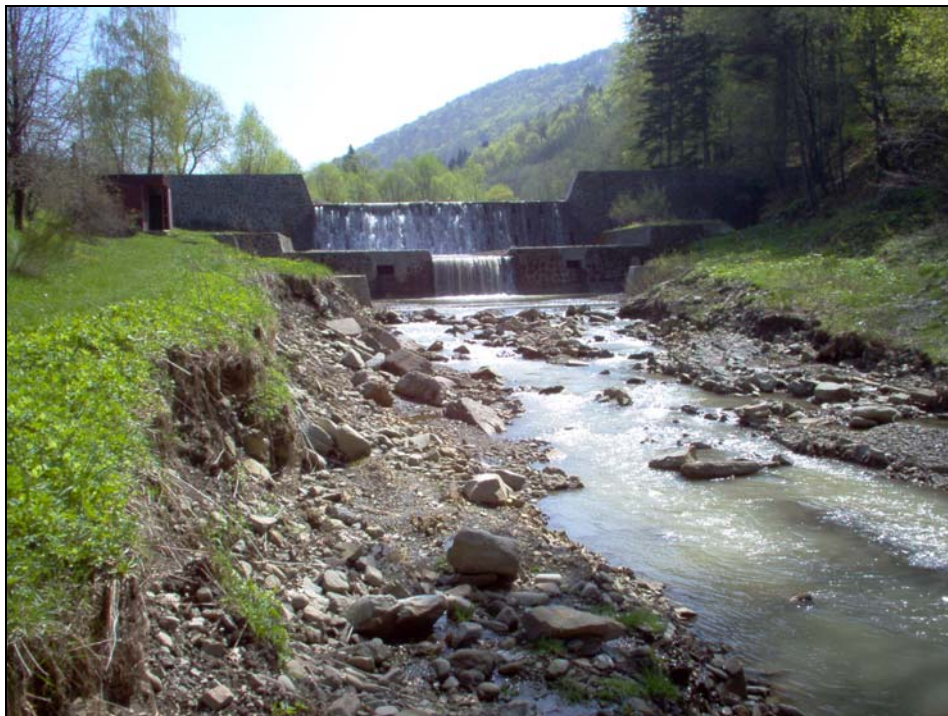
Rysunek 3. Zniszczenia koryta poniżej zapory
