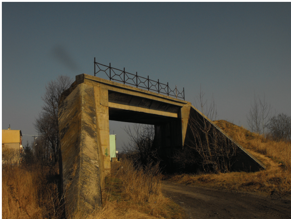
Rysunek 3. Widok wiaduktu kolejowego na trasie nieczynnej linii kolejowej Wołów – Lubiąż w rejonie obrębu Mojęcice (autor: Heldak ).
