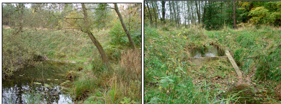
Rysunek 3. Korpus drogi pełniący funkcję grobli i przepusto-zastawka typu PP1/60 (fot. I. Tereszczak)
