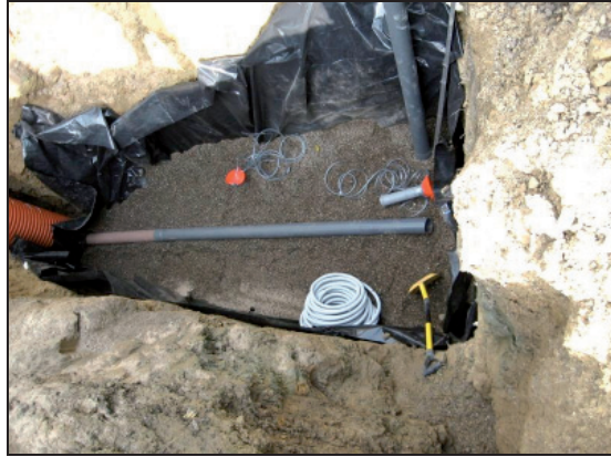
Fotografia 12. Układanie drenu zbierającego ścieki oczyszczone Photo 12. Installation of treated sewage collection drain
