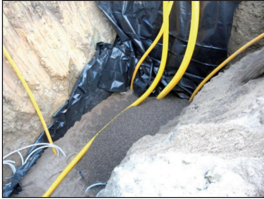
Fotografia 17. Układ przewodów napowietrzających złoża Photo 17. Bed aeration pipe system
