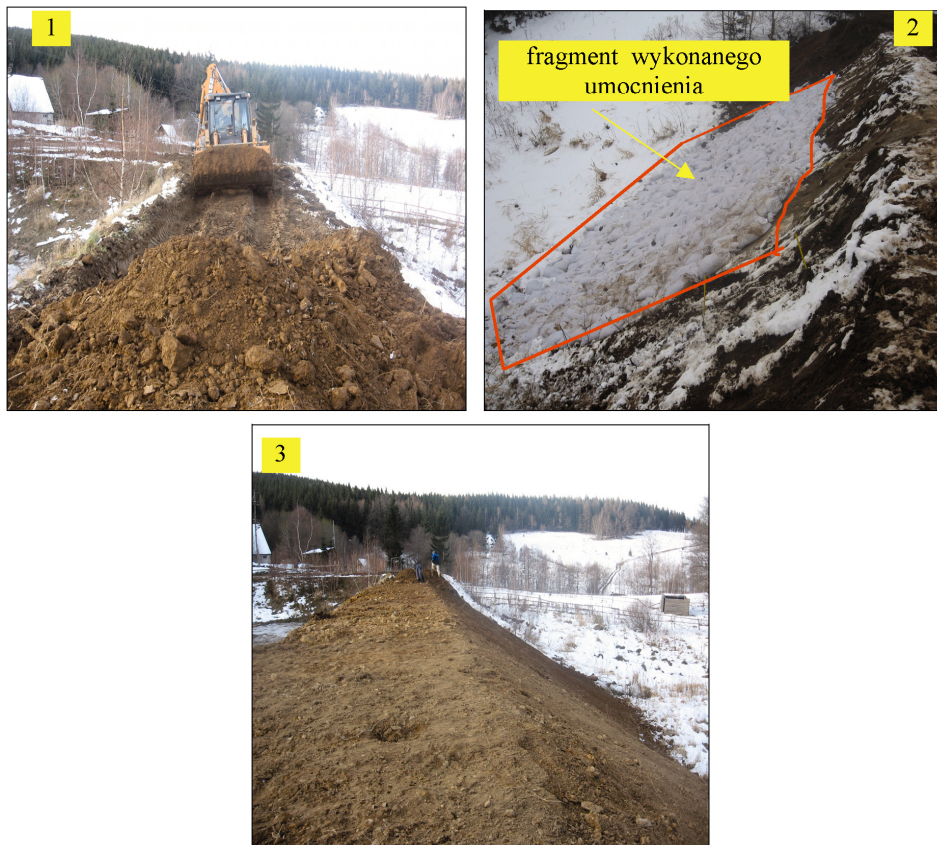
Fotografia 1. Dowóz gruntu do nadbudowy skarpy. Głębokie koleiny powstały z braku pierwotnego zagęszczenia
