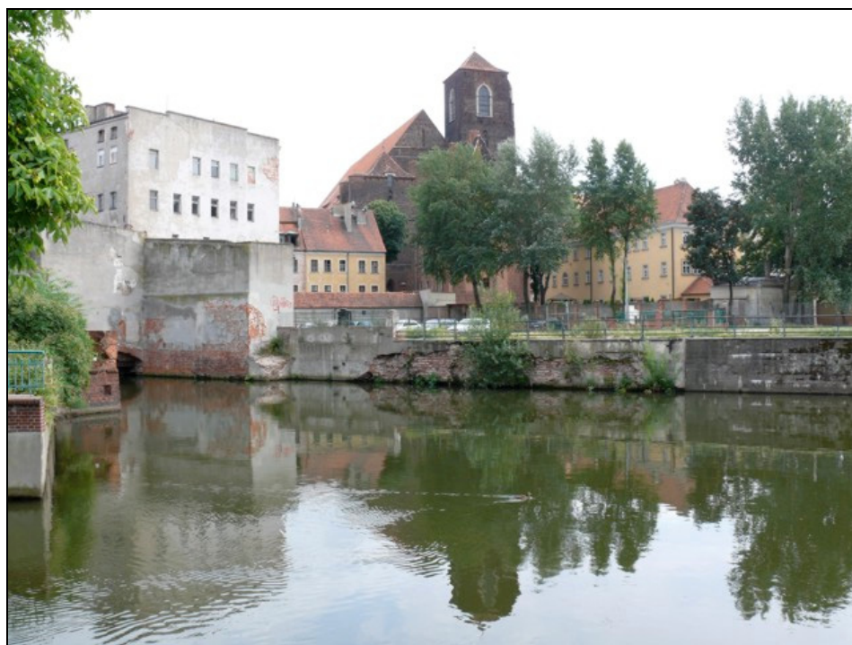
Fotografia 7. Zniszczone ceglane mury oporowe poniżej młyna Maria we Wrocławiu (zdjęcie autorów, czerwiec 2008 r.)
