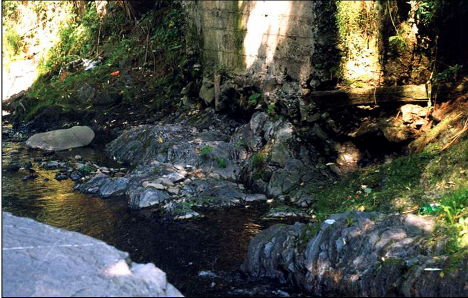
Fotografia 6. Uszkodzone filary mostu w korycie Mszanki – efekt erozji wgłębnej (fot. J. Korpak)
