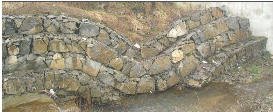
Fotografia 1. Uszkodzone umocnienie brzegu, potok Wyskitnianka, 2007 r. Picture 1. The bank protection failure, the Wyskitnianka stream, 2007
