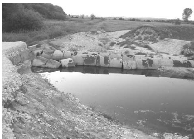
Rysunek 3. Widok drugiego rozmycia wału przeciwpowodziowego Figure 3. The view of the second broken embankment
