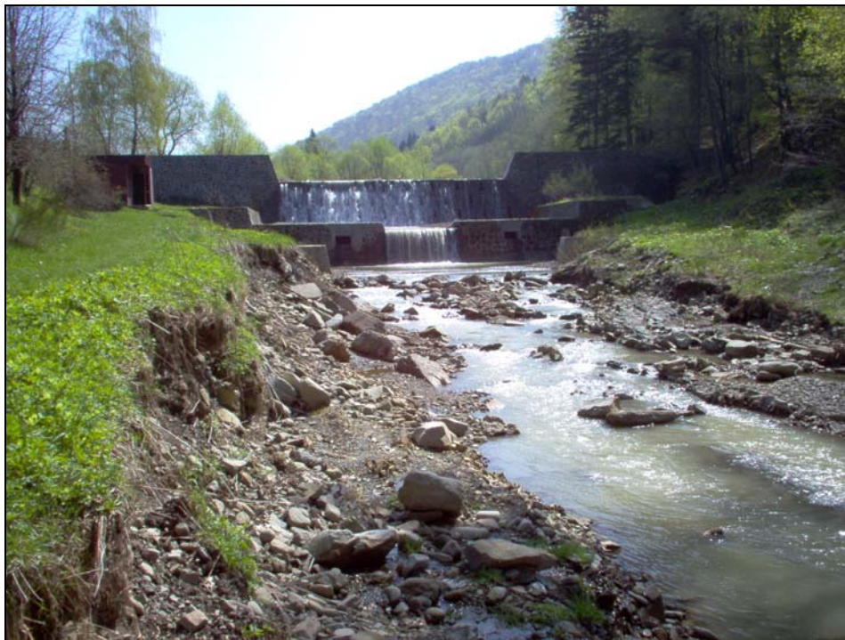
Rysunek 3. Zniszczenia koryta poniżej zapory
